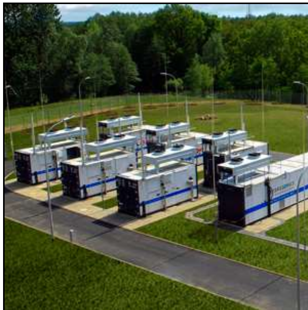
Figura 10 – Sistema de eletrólise em Falkenhagen, na Alemanha [10]
