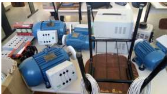
Figura 23: motores localizados em local inapropriado e distribuídos de forma irregular.
