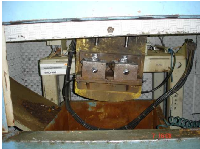
Figura 16 vista do dispositivo de vibração
