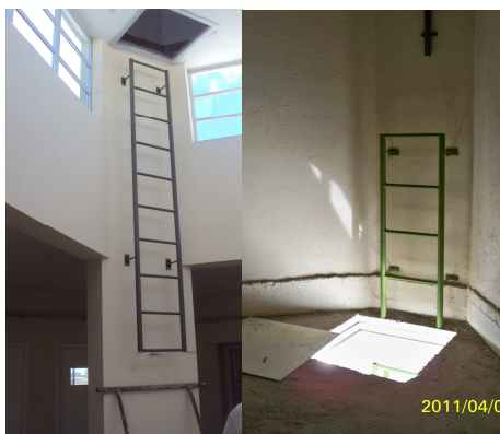
Escada de marinheiro
